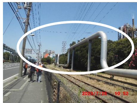
川崎発電所から周辺コンビナートに供給しているパイプライン。蒸気の共用で CO 2 の削減効果は約 2.5 万トン
