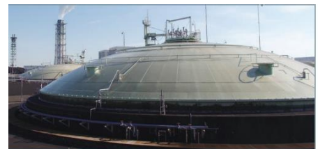
地下タンクの頭の部分 ホームページより参照
