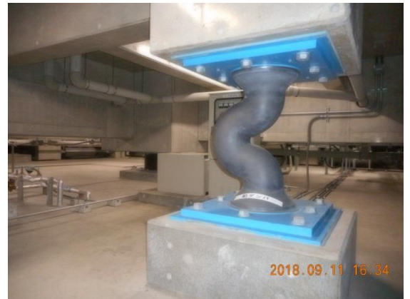
防災センターの免震装置
