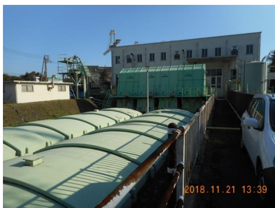
大師河原ポンプ場の4つの除塵機。ここで雨水を取り込んだ時のごみなどを取り除く機械です。
