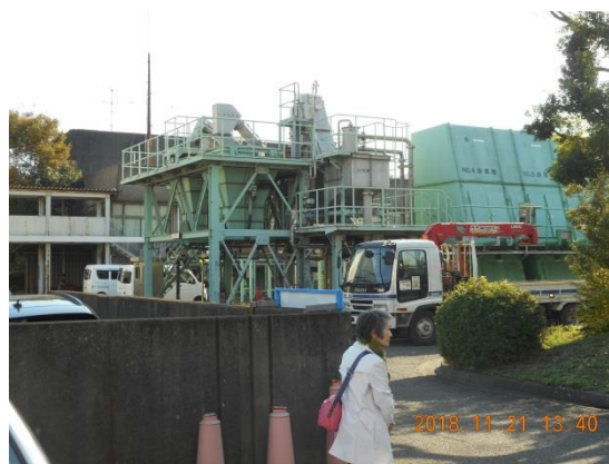
汚水の除塵機
