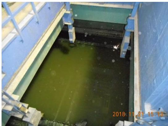
最初沈殿池の流入水
