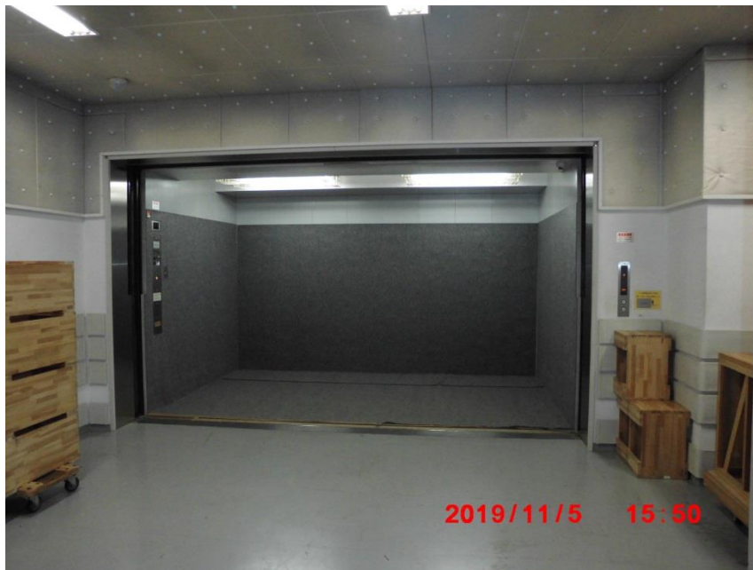
楽器を搬入搬出するエレベーター。
