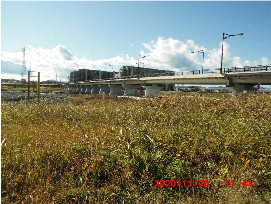
日野橋。日野市と立川市を結ぶ橋、架け替え工事が始まっていました。
